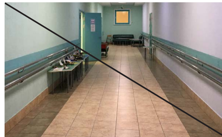
Плохо Керамогранитная плитка с крупными швами
